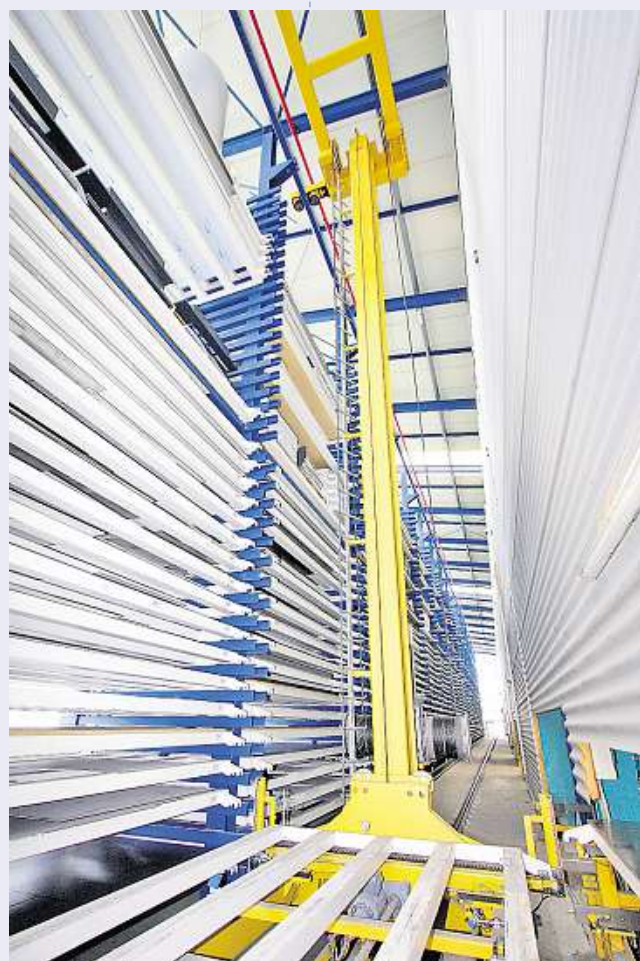
Das Hochregallager: Modernste Technik ist hier im Einsatz.
